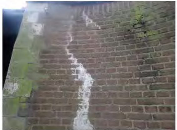
Foto 02: Kleine scheur bij aansluiting op frontwand brug
