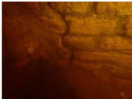
Foto 14: Verticale scheur H17 onder water
