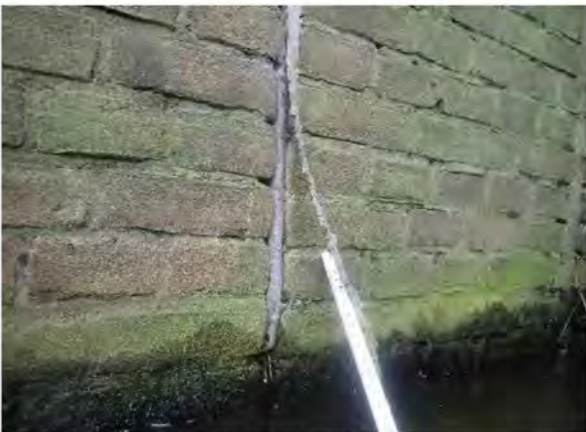
Foto 05: Kitvoer dilatatie laat los
