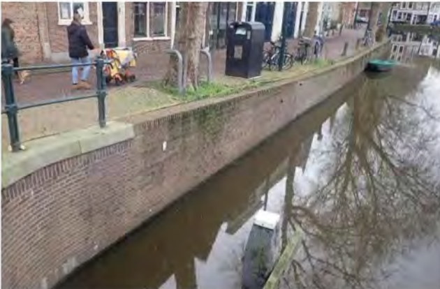
Foto 01: Bovenzijde en voorzijde walmuur
