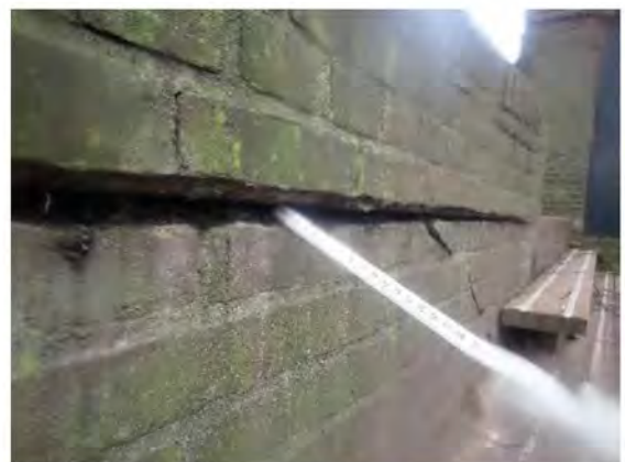
Foto 10: Bovenlaag metselwerk schuift af
