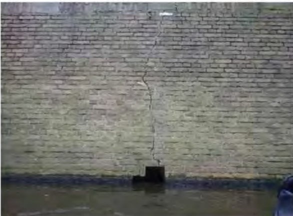
Foto 03: Verticale scheur boven uitstroomopening
