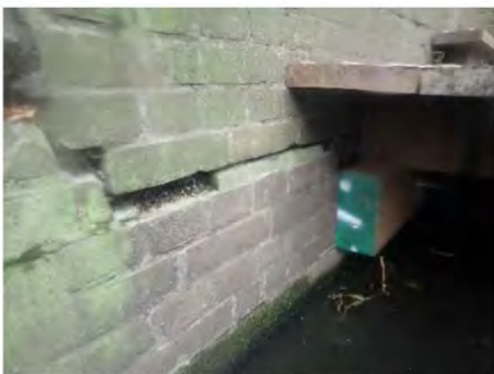
Foto 11: Scheuren in walmuur bij vlonder
