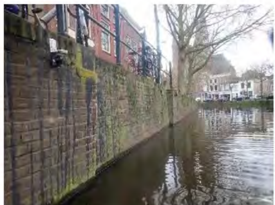
Foto 06: Sprong in walmuur bij dilatatievoeg
