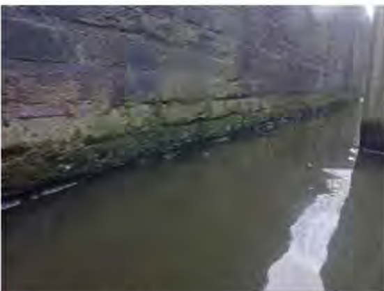
Foto 03: Uitgesleten voegwerk rondom waterlijn
