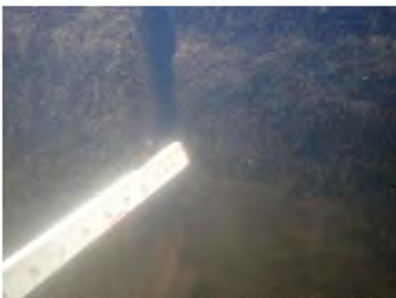
Foto 05: Scheur (I5) doorlopend onder water
