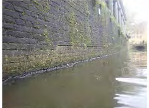
Foto 02: Horizontale scheur over lintvoeg
