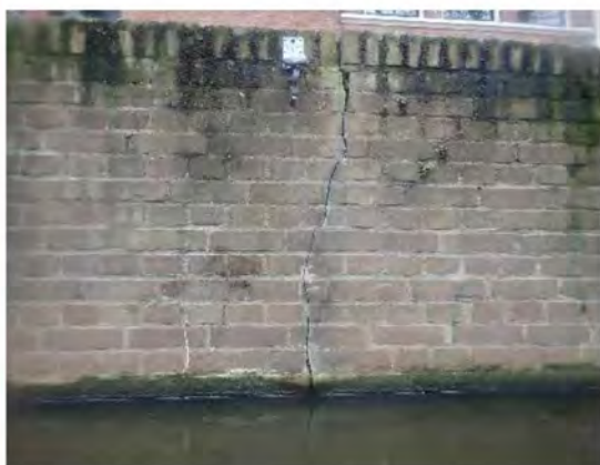
Foto 11: Scheur boven water (H16)
