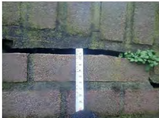
Foto 02: Openstaande naad rollaag
