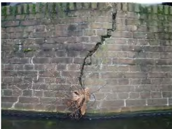
Foto 03: Scheur in walmuur I4
