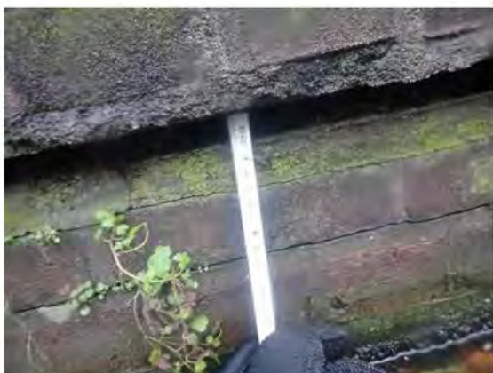
Foto 5: Afschuiving bovenzijde walmuur
